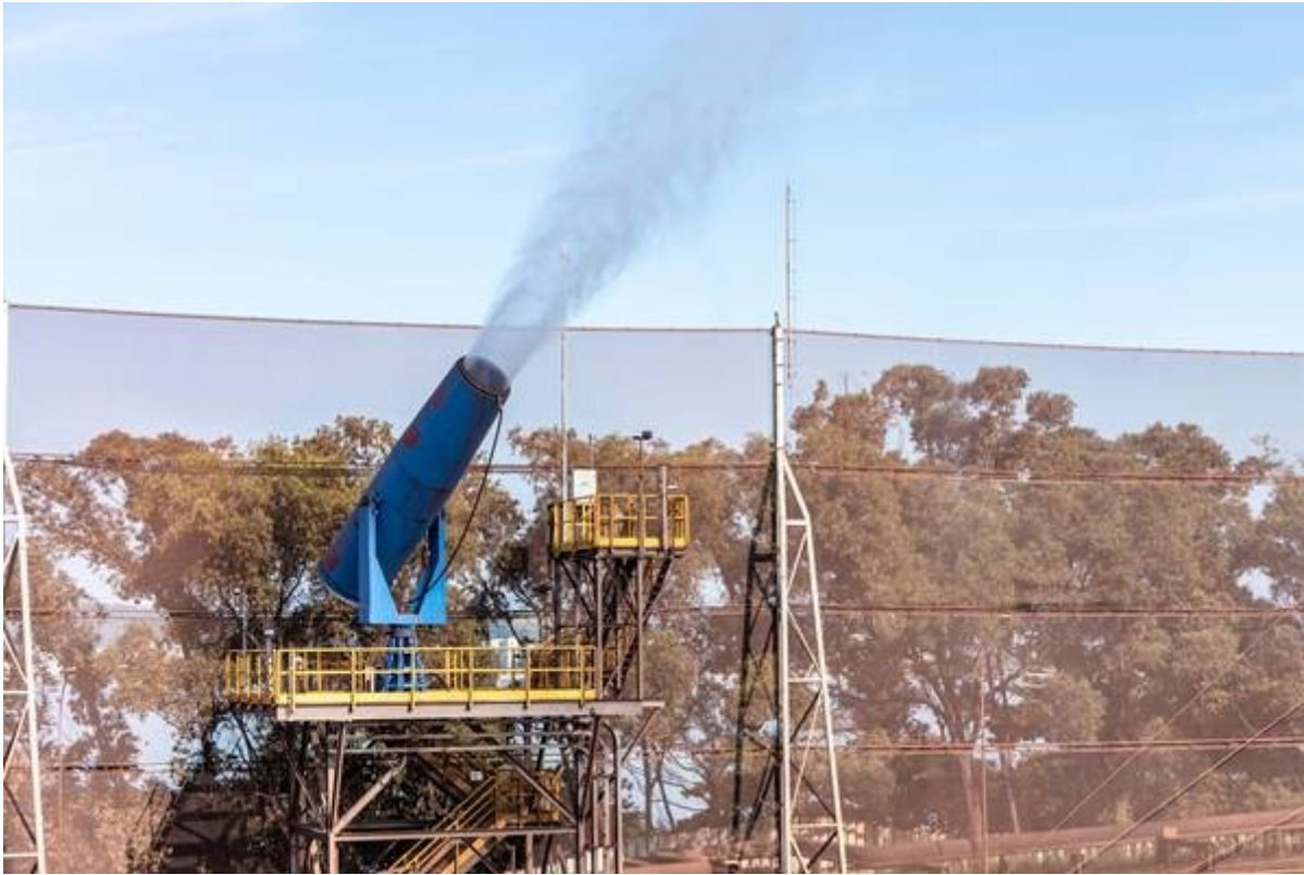
Canhão de névoa no pátio de pelotas da Vale
