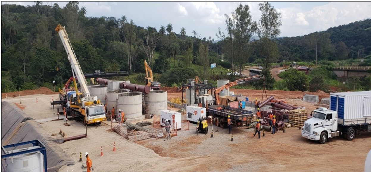
Estação de Tratamento de Água no Ribeirão Córrego-Carvão está em fase de testes
