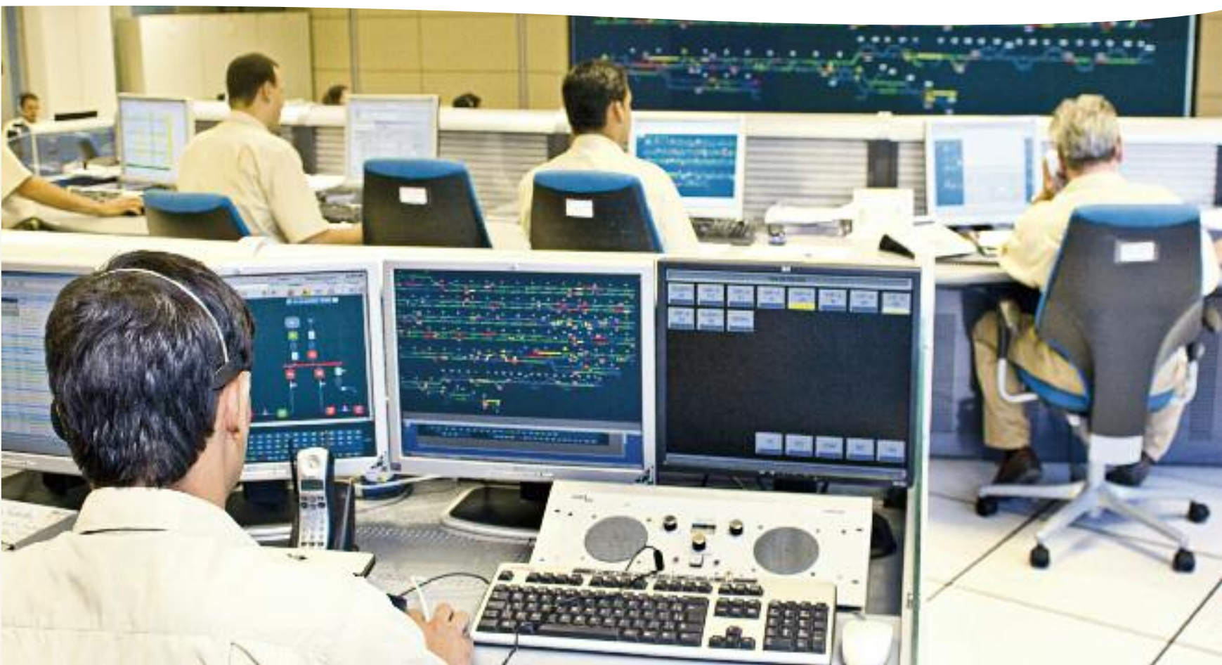
Sala de controle EFVM Tubarão (ES-Brasil).
