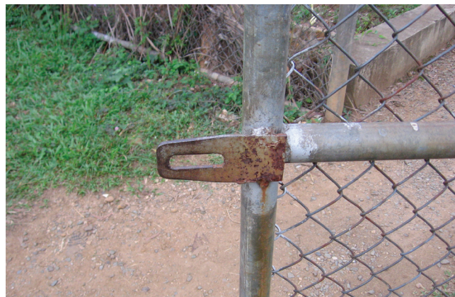
Gambar 28. Pintu gerbang berbahan dasar kawat harmonika yang sama besar dipergunakan untuk pagar, yang dapat dipergunakan di penangkaran rusa dengan sistem engsel dan pengunci yang kuat (foto: G. Semiadi).
