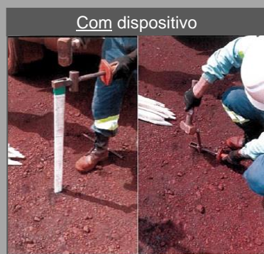
Com dispositivo Atividade de punção de pino e locação de estaca com o dispositivo
